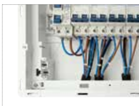
Большое пространство для подключения оборудования
